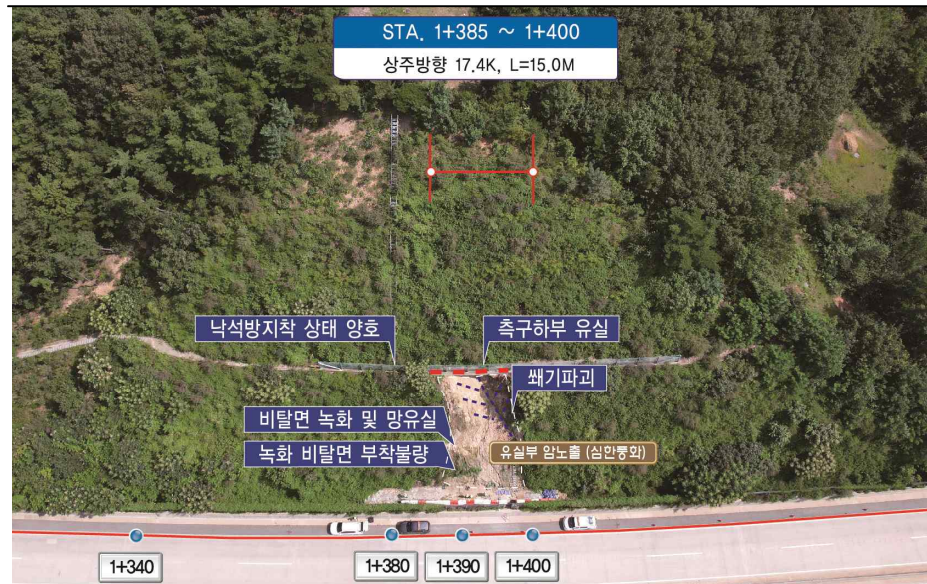
〈비탈면 붕괴현황 전경, 현장사진 2023.09.05.〉
