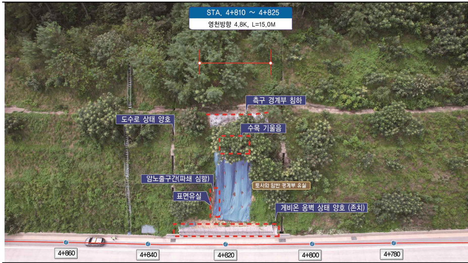
〈비탈면 붕괴현황 전경, 현장사진 2023.09.05.〉
